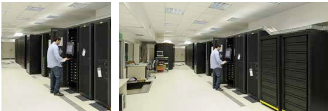
Divisione ICT - ENEA, Sala calcolo sistema CRESCO, vista complessiva.
