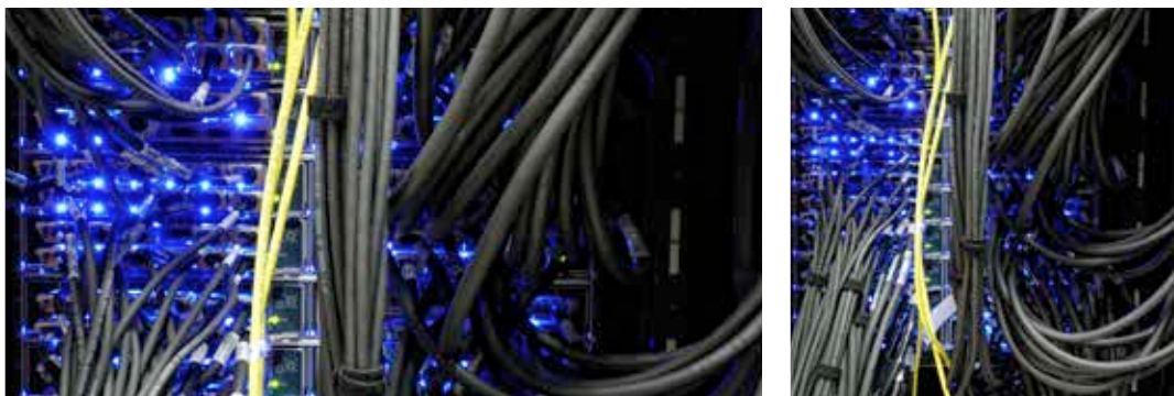
Divisione ICT - ENEA, Sala calcolo CRESCO, particolare dello Switch Infiniband DDR
